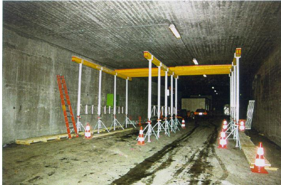
Abb. 1: Vorgefertigte Stützenkonstruktion zur Sicherung der Zwischendecke. Das Material ist in den Werkhöfen jederzeit einsatzbereit und der Einbau wird von den Einsatzequipen periodisch geübt.
