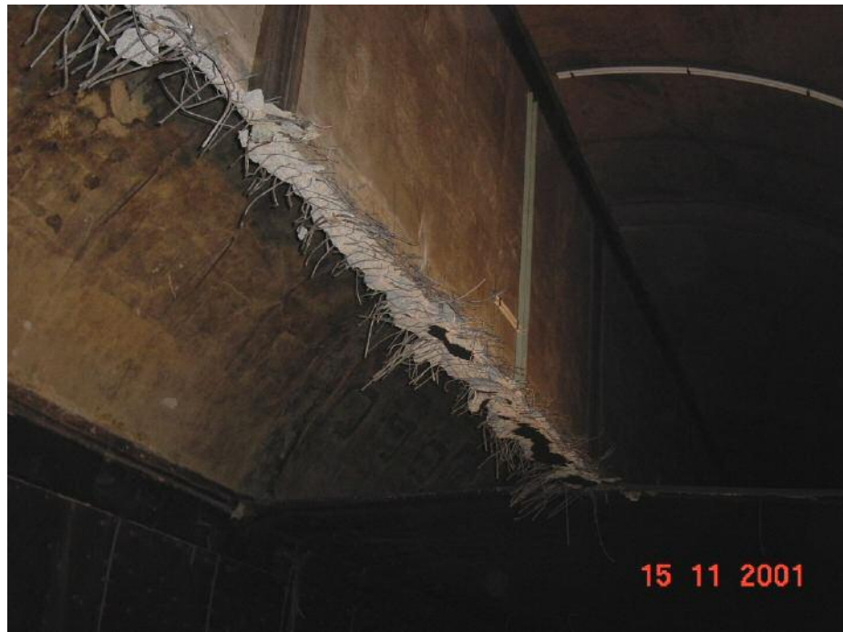
Abb. 5: Blick in das Tunnelgewölbe nach Abbruch der Zwischendecke. Man kann deutlich erkennen, dass die Fugenisolationen der Trennwand sowie die Kabelkanäle keine Brandschäden aufweisen.
