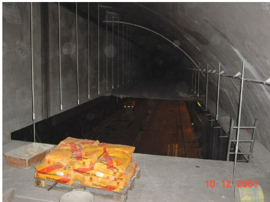
Abb. 9: Decke im Montagezustand (Frischlufthkanal). Rechts ist das am Gewölbe befestigte Strahlungskabel (Funk/Radio) erkennbar. Es blieb während dem Brand intakt und funktionstüchtig.
